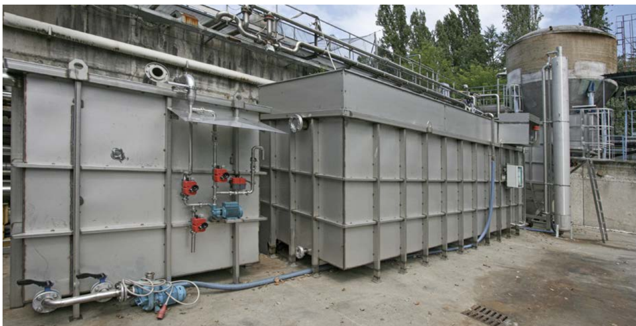
Figura 1. Assieme gruppo di reazione, sedimentazione, ossidazione biologica e chiarificazione MBR.
