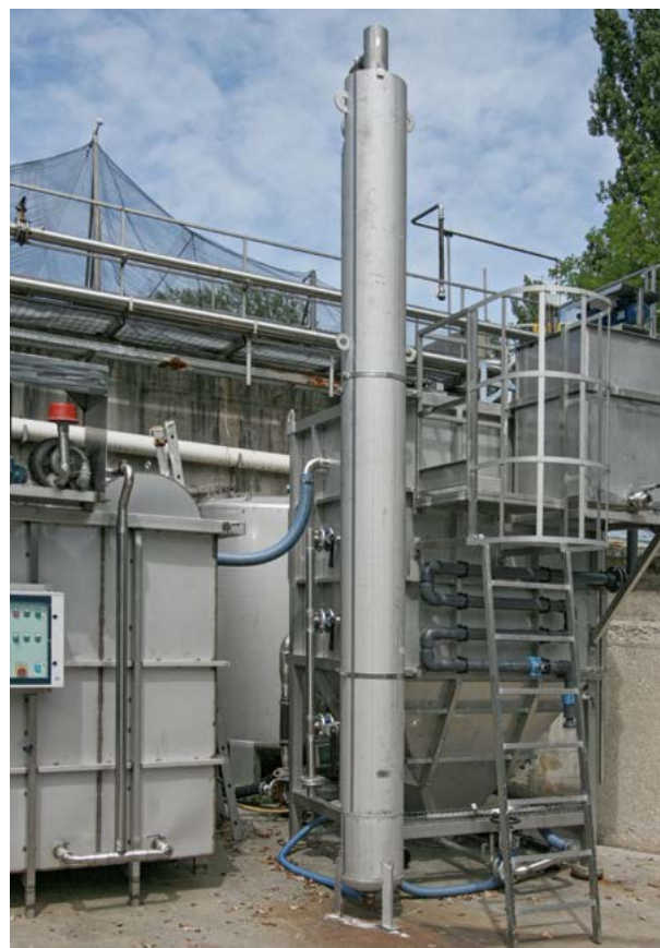
Figura 2. Sedimentazione assistita e ispessimento fanghi.
