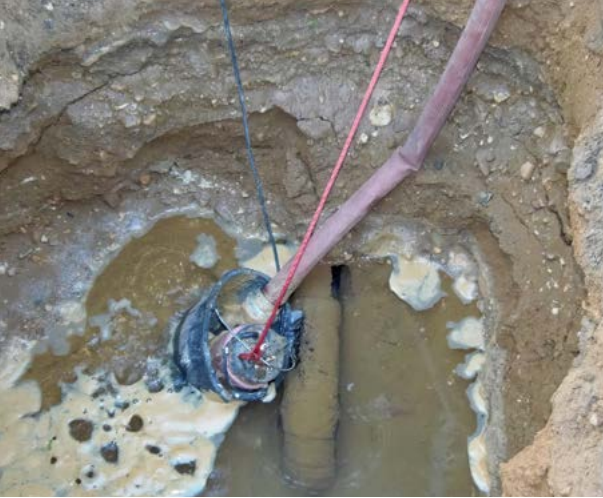
Figura 1. Esempio di perdita da una tubazione di acqua di raffreddamento.
