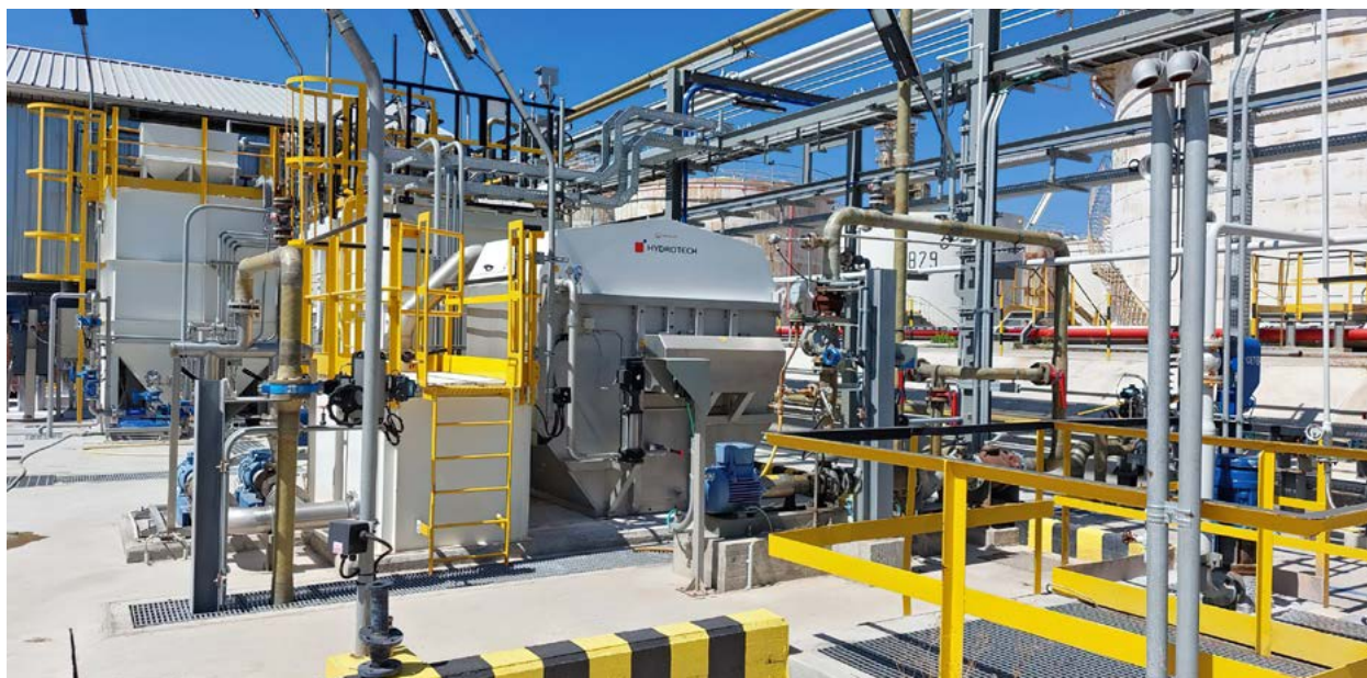
Figura 4. Installazione presso uno stabilimento del settore chimico in Sicilia.
